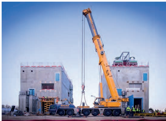
Mise en place d'un diesel d'ultime secours à la centrale nucléaire de Saint-Laurent-des-Eaux, novembre 2016.
