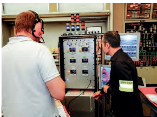
Salle de contrôle de la centrale nucléaire de Cruas-Meysses.
