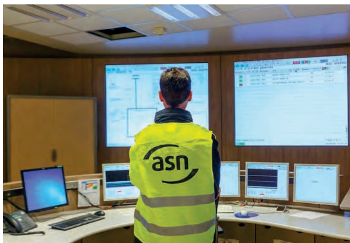
Salle de commande de l'EPR.
