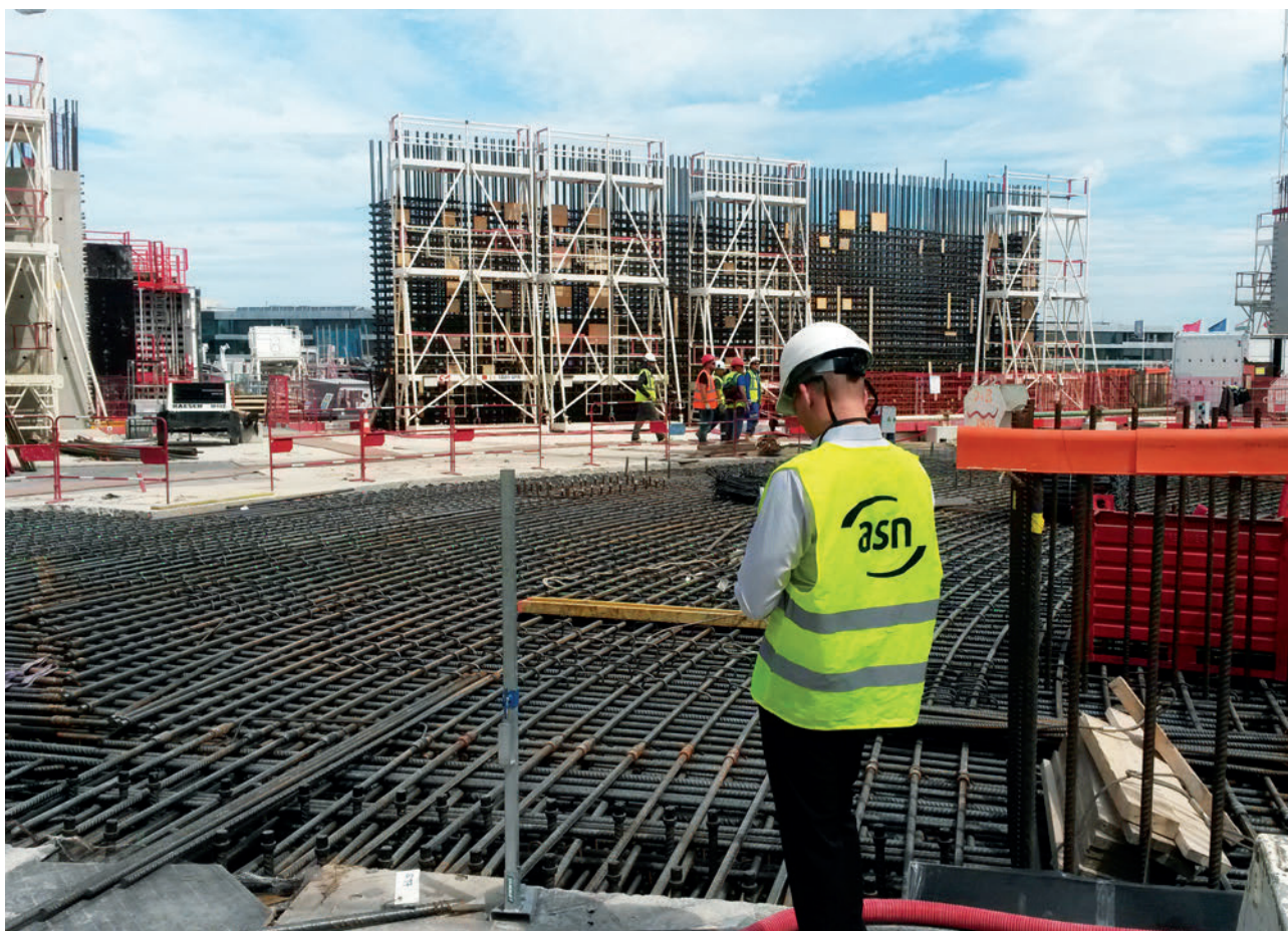
| Inspection de l'ASN sur le chantier du réacteur Tokamak de ITER, mai 2017.
