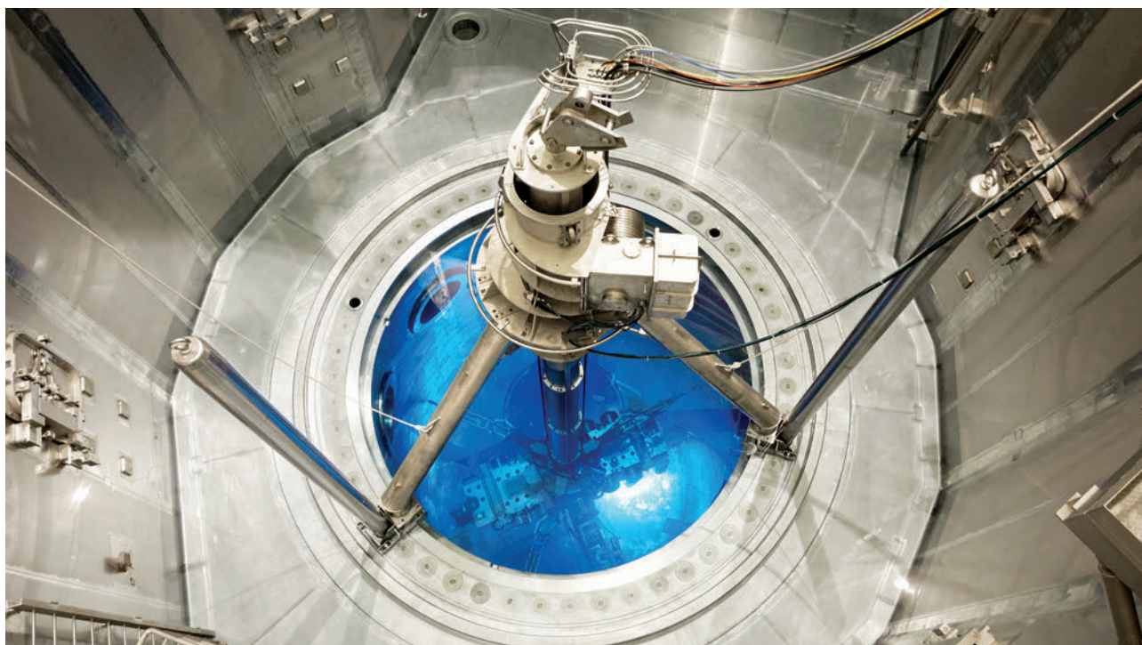
Contrôles de la cuve de l'EPR par la machine d'inspection en service, septembre 2017.
