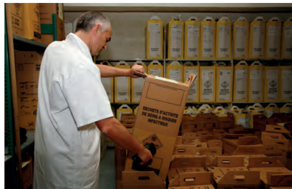
Inspection de la division de Nantes de l'ASN dans le local des déchets radioactifs du CHU de Nantes (Loire-Atlantique) – Septembre 2007
