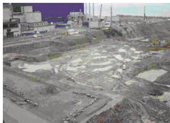
Chantier de construction de l'EPR à Flamanville (Manche) – Août 2007 : travaux de préparation du site
