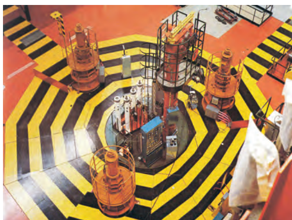
Plateforme du réacteur PHÉNIX à Marcoule (Gard)
