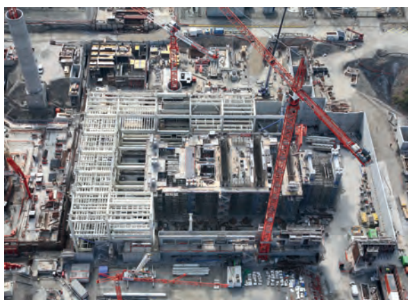
Chantier de construction de l'EPR à Flamanville (Manche) – Septembre 2008 : construction de la salle des machines
