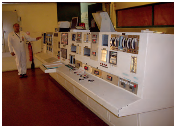
Salle de conduite de la Conversion avant modification – Août 2007
