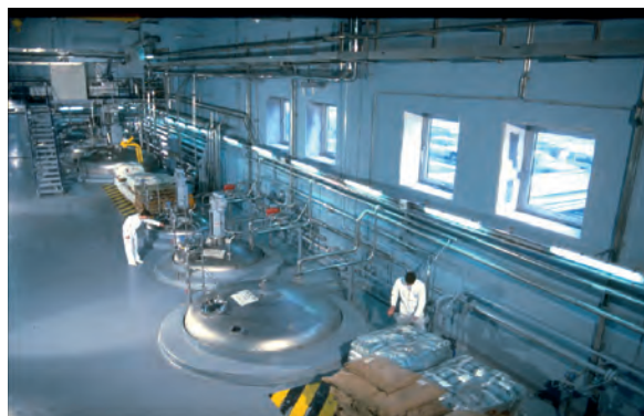
Hall des réactifs de la station de traitement des effluents, STE3 – AREVA NC à La Hague (Manche) – 2006
