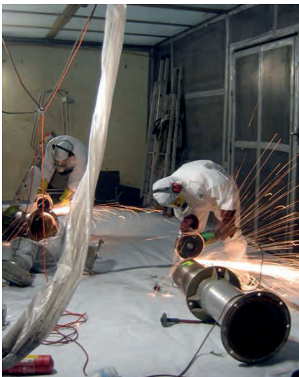
Opérateurs réalisant des opérations de découpe lors du démantèlement des ATUE à Cadarache (Bouches-du-Rhône)
