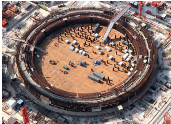
Chantier de construction de l'EPR à Flamanville (Manche) – Septembre 2008 : construction du bâtiment réacteur muni de sa peau d'étanchéité métallique interne
