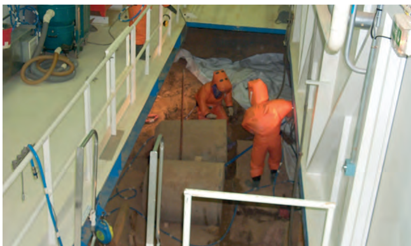
Opérateurs travaillant sur le chantier de reprise des déchets en tranchées de l'INB 56 à Cadarache (Bouches-du-Rhône)
