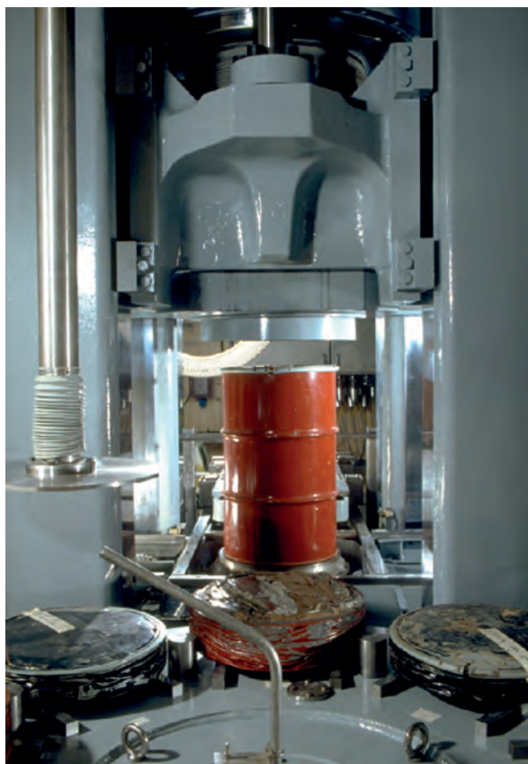
Presse à compacter les déchets de faible activité dans l'atelier AD2 – AREVA NC à La Hague (Manche) – 2007
