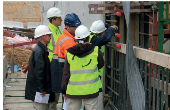
Inspecteurs de l'ASN réalisant une inspection sur le chantier de construction de l'installation MAGENTA
