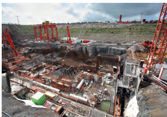
Chantier de construction de l'EPR à Flamanville (Manche) – Septembre 2008 : construction de la station de pompage
