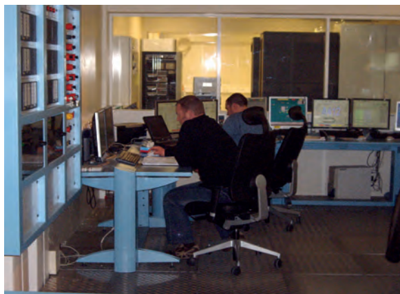
Salle de conduite de la Conversion après modification – Novembre 2008
