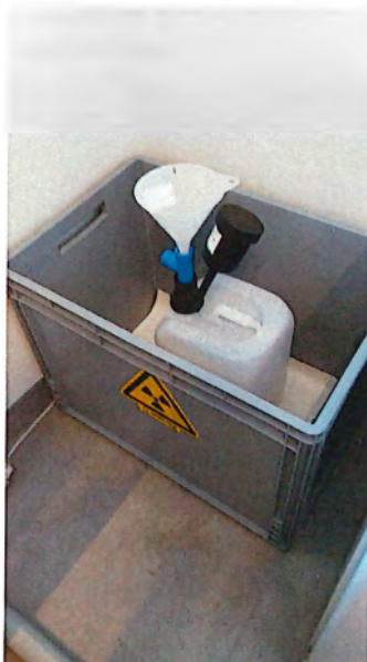
Figure 2 : Stockage intermédiaire effluents liquides en IMA-01
