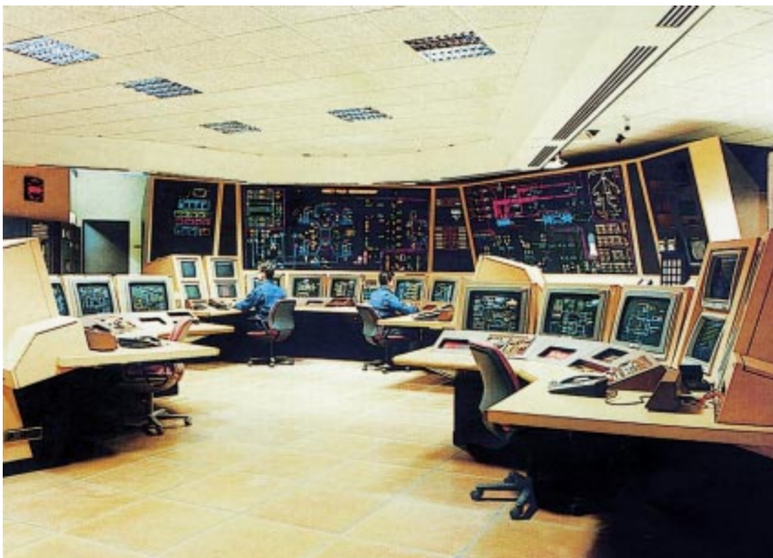
Vue d'ensemble de la salle de commande du palier N4
