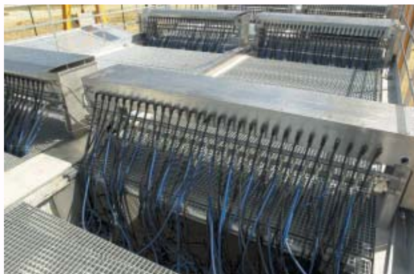
Station de traitement par UV des rejets de la centrale de Civaux (prévention des amibes)
