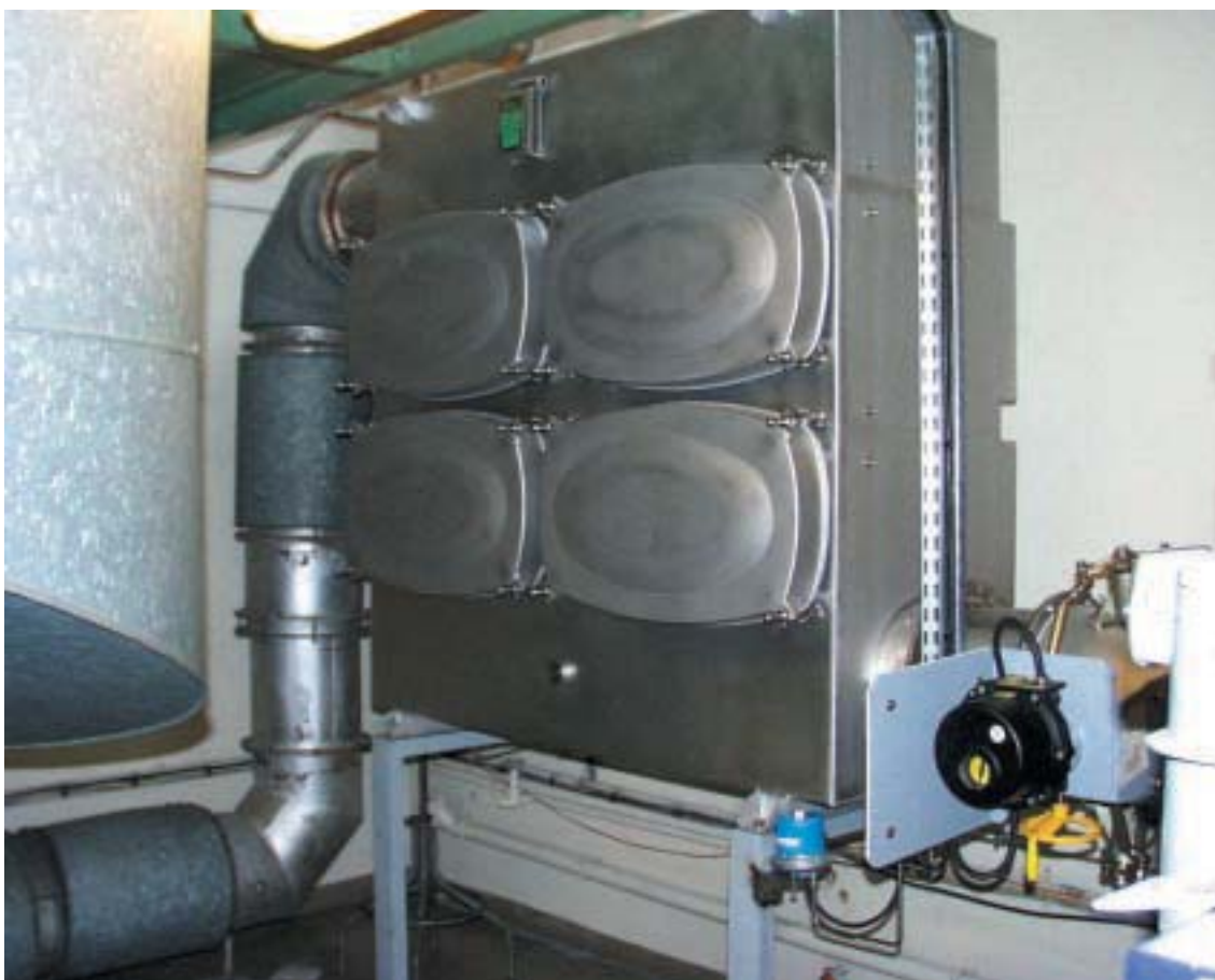
Doublement du dispositif de filtration d'un équipement d'INB pour réduire l'activité des rejets gazeux
