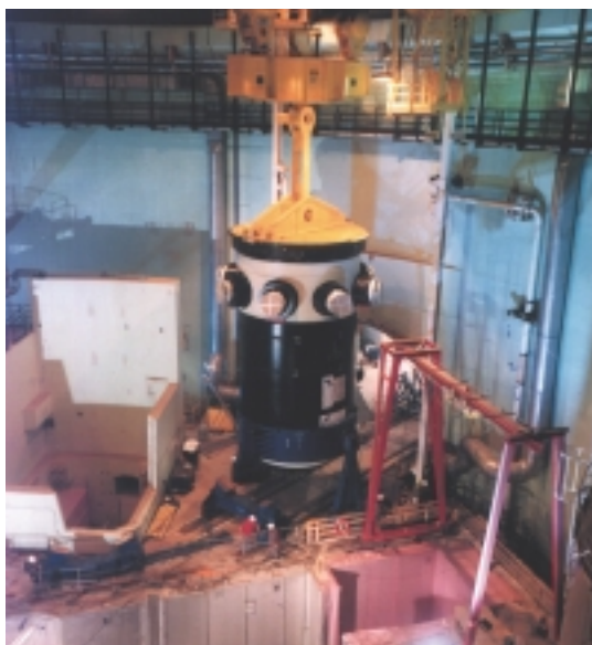
Cuve du réacteur de Civaux avant sa mise en place dans son emplacement au fond de la piscine (premier plan)
