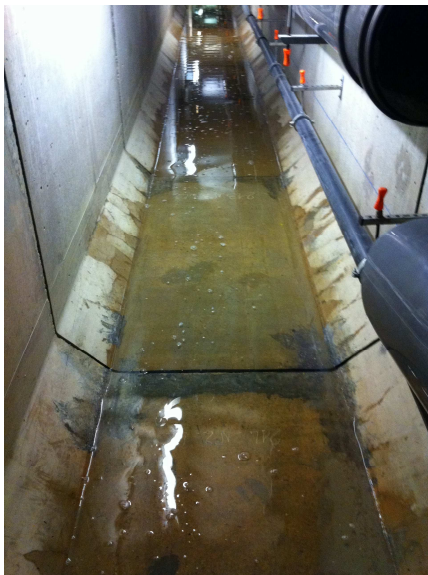
Photo prise dans la galerie E13 du RSGE illustrant une flaque d'eau qui s'étend sur quasiment toute la longueur de la galerie et qui atteint par endroit une hauteur de l'ordre de 2 cm.
