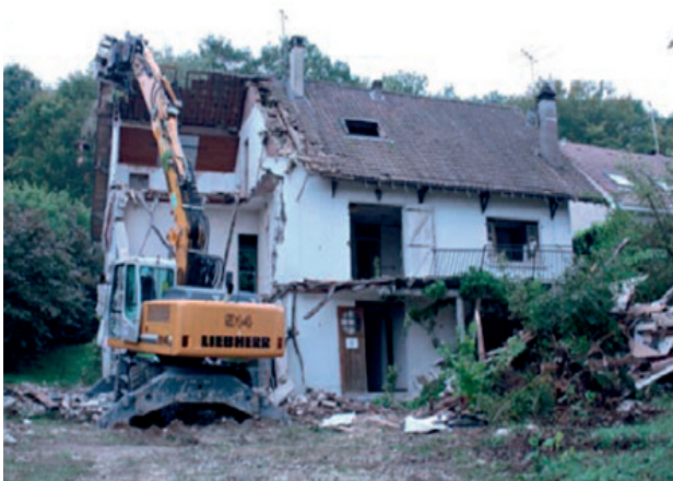
Destruction d'une maison à Gif-sur-Yvette
