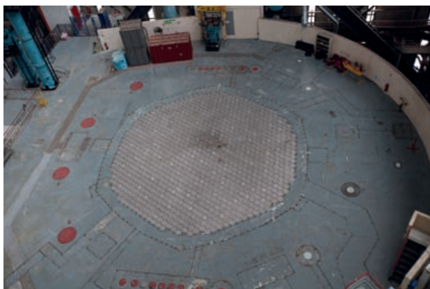
Nid d'abeille graphite dans la zone de chargement du combustible dans un réacteur graphite-gaz UNGG – Chantier de déconstruction de Bugey 1 – Août 2011
